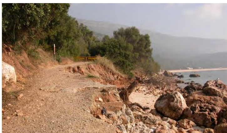
Figura 32: Efeitos da erosão costeira sobre o caminho de terra batida que efetua a ligação rodoviária/pedonal entre o Creiro e o Portinho da Arrábida. Data: 20/01/2010.
