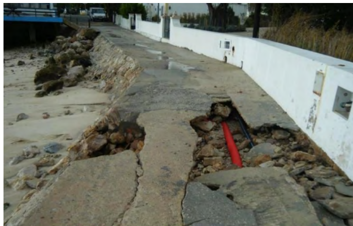
Figura 29: Destruição na via que dá acesso à praia do Creiro através do Portinho da Arrábida devido à agitação marítima. Data: 01.03.2018
